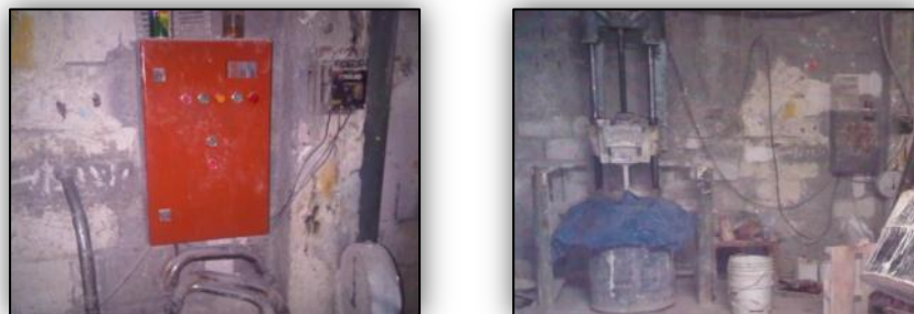
FIGURA 5.7. TABLERO DE CONTROL DE MÁQUINA MEZCLADORA
