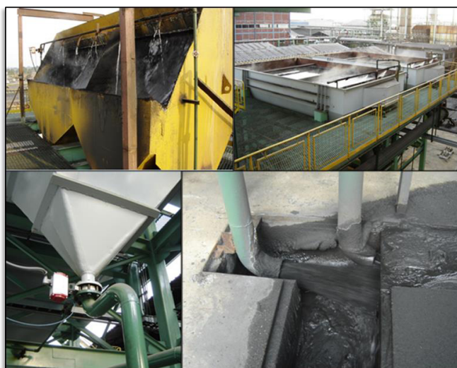
FIGURA 4.35. NUEVO SISTEMA DE CLARIFICACIÓN DE AGUA CON CENIZA (1ERA ETAPA) EN PLENA OPERACIÓN.
