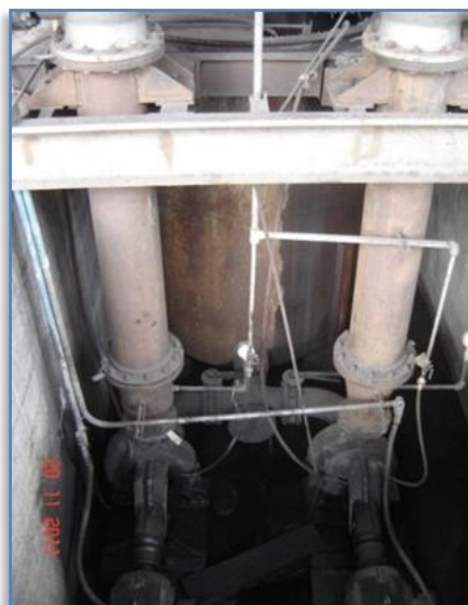
FIGURA 4.2. TANQUE RECEPTOR Y BOMBAS
