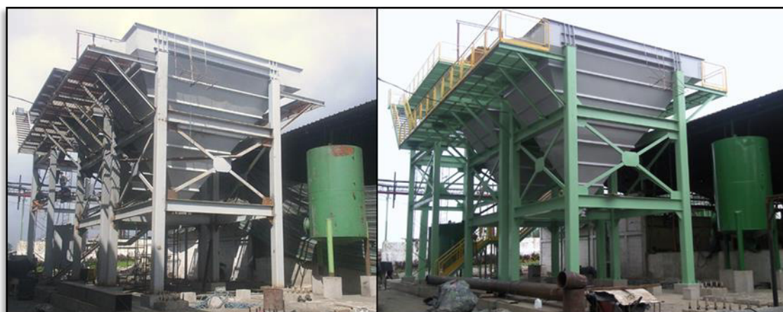
FIGURA 4.29. NUEVO SISTEMA DE CLARIFICACIÓN ANTES Y DESPUÉS DE APLICADA SU CAPA FINAL DE PINTURA.
