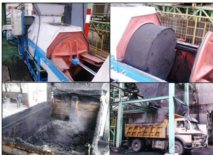
FIGURA 4.45. PRENSA DESAGUADORA EN PLENA OPERACIÓN.
