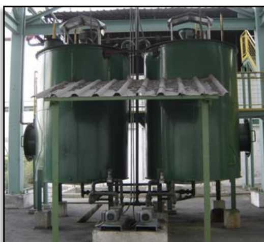
FIGURA 4.8. ESTACIÓN DE FLOCULANTE
