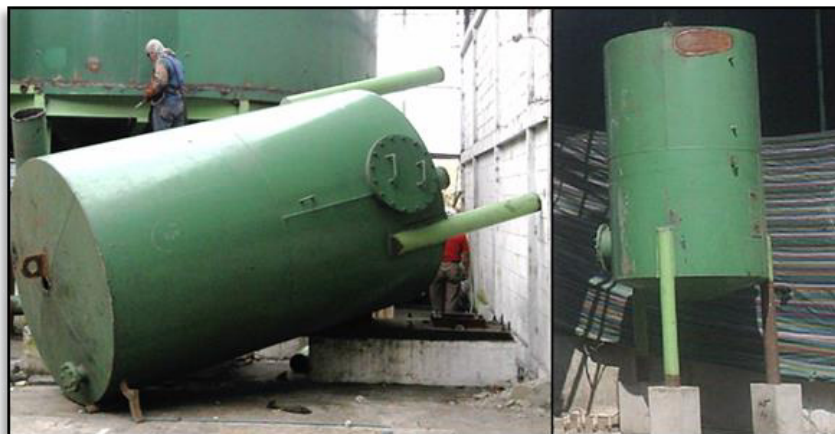
FIGURA 4.28. TANQUE DE AGUA TRATADA.
