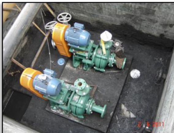
FIGURA 4.11. TANQUE DE DRENOS
