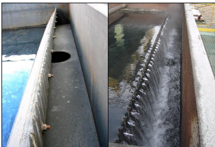
FIGURA 4.33. VERTEDERO DE CELDAS DE DECANTACIÓN. A LA IZQUIERDA SE OBSERVAN LOS PERNOS DE AJUSTE DE ALTURA.
