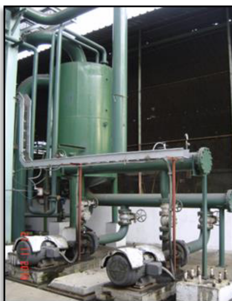
FIGURA 4.9. TANQUE DE AGUA TRATADA
