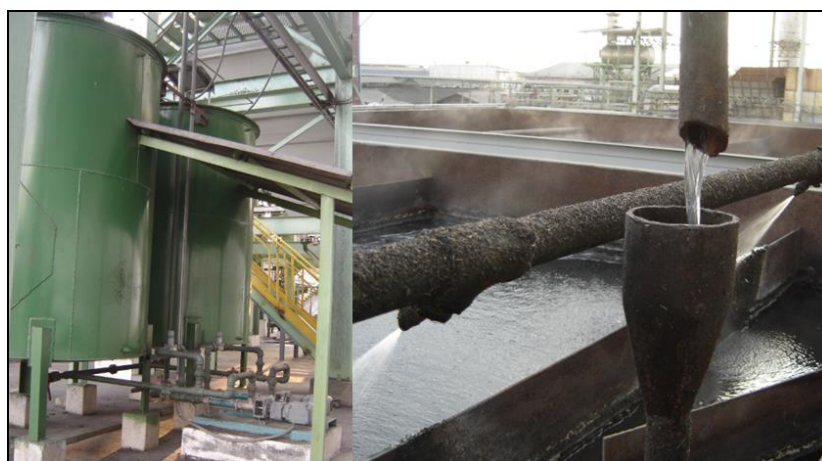
FIGURA 4.34. ESTACIÓN DE BOMBEO DE FLOCULANTE Y DOSIFICACIÓN DE FLOCULANTE A UNA DE LAS CELDAS.
