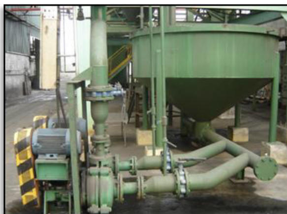
FIGURA 4.10. TANQUE DE LODOS
