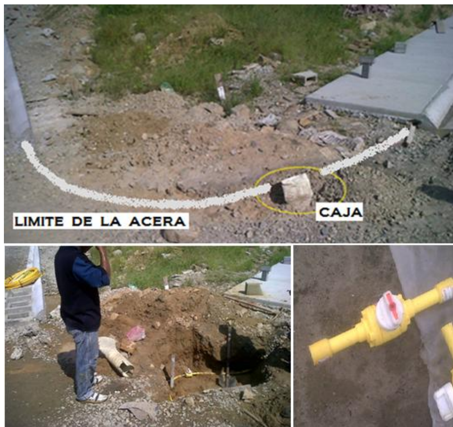
FIGURA 30: DAÑOS Y REPARACIONES DE POLIVÁLVULAS
