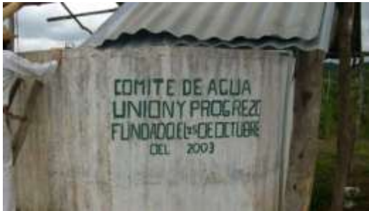
Reservorio del comité de agua “ Unión y Progreso”, La Unión
