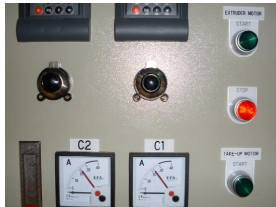
FIGURA 3.11 Botones de encendido y apagado del Motor Principal y de los Rodillos de Tiro; Amperímetro del calentador C1 y C2
