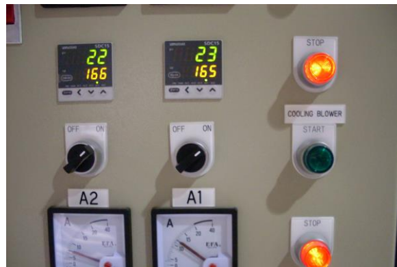
FIGURA 3.12 Termómetro y Botones de encendido del calentador C1 y C2; Botón de encendido y apagado del Blower
