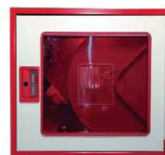
Boca de incendio equipada de 45 mm
