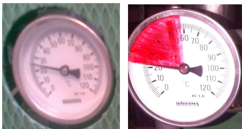
FIGURA 4.8. CONTROL VISUAL EN MANÓMETROS
