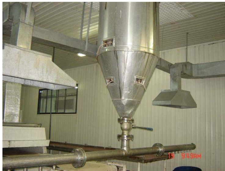
FIGURA 5. TANQUE COLECTOR DE MASA COCIDA
