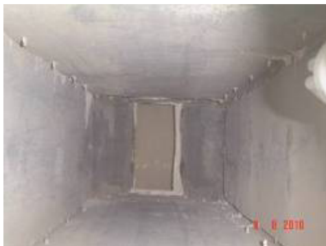
Vista Interior del Filtro
