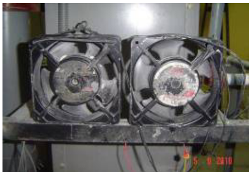
Ventiladores de Agitación y Mezcla
