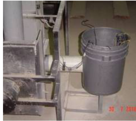
Tanque conectado al Filtro
