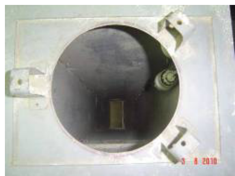
Vista Superior del Filtro
