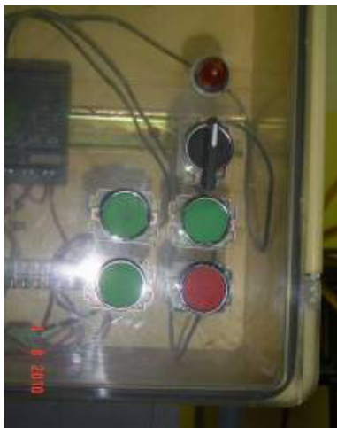
Switch del PLC – Cierra
