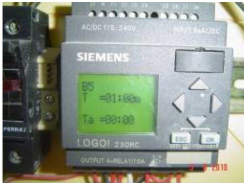
Entrada del Parámetro B5 al PLC
