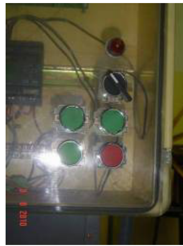
Switch del PLC - Abre
