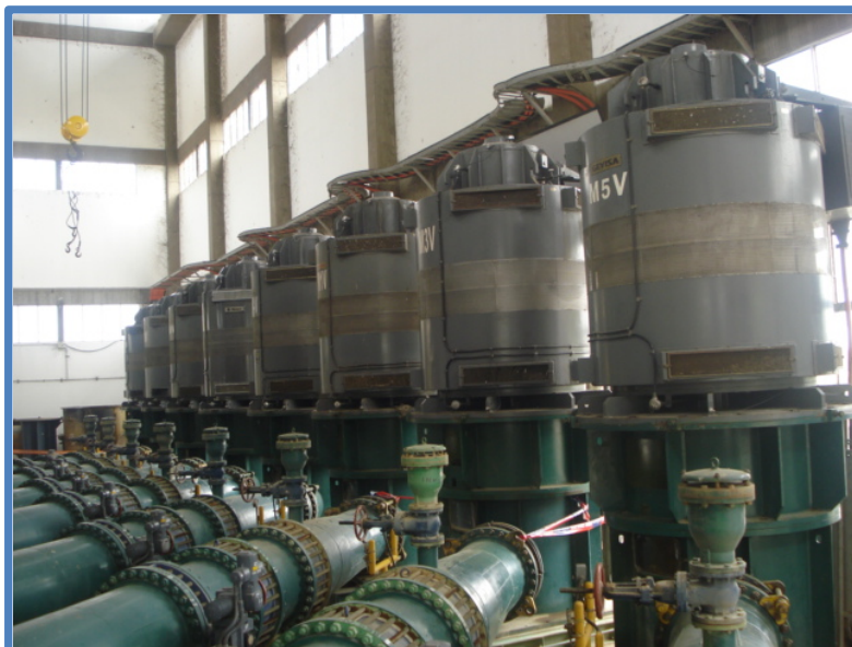
Figura 10.- Estación de Bombeo EB4
