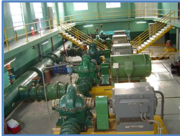
Figura 6.- Estación de Bombeo EB 2
