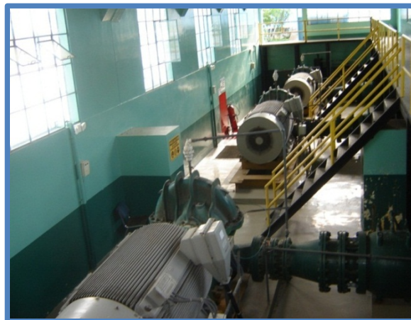
Figura 8.- Estación de Bombeo EB3
