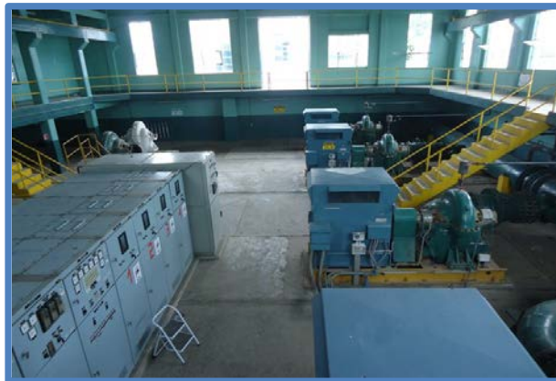
Figura 4.- Estación de Bombeo 1
