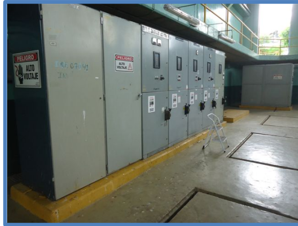
Figura 7.- Tablero de Motores Estación EB 2
