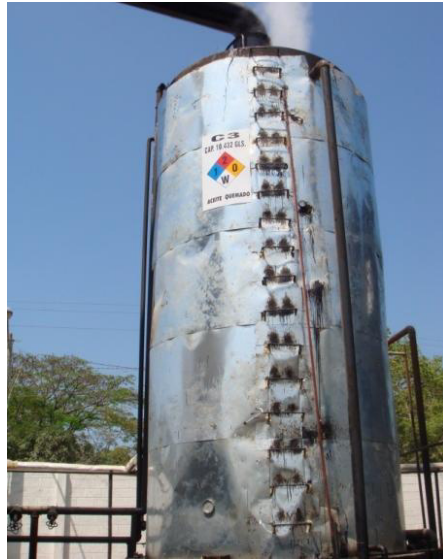
FIGURA 1.3. TANQUE DE DESTILACIÓN
