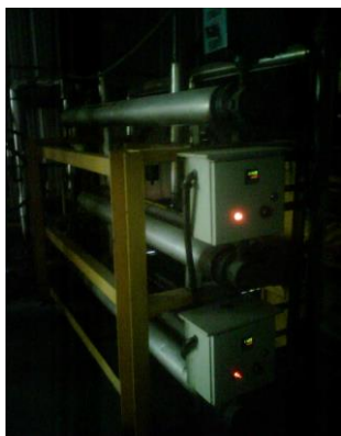
Fig. 3.8 Precalentador de Bunker
