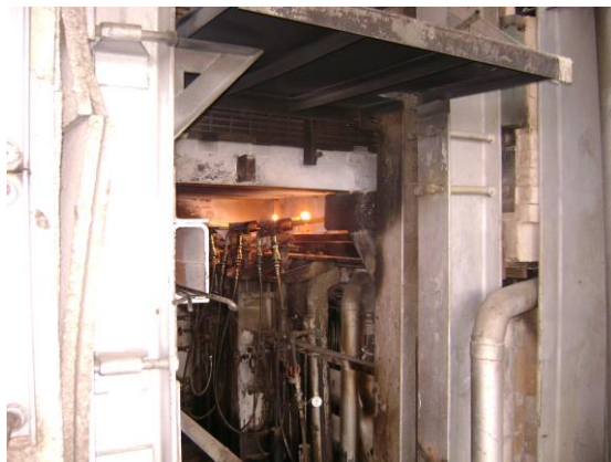
Fig. 3.12 Área de Quemadores (antes)
