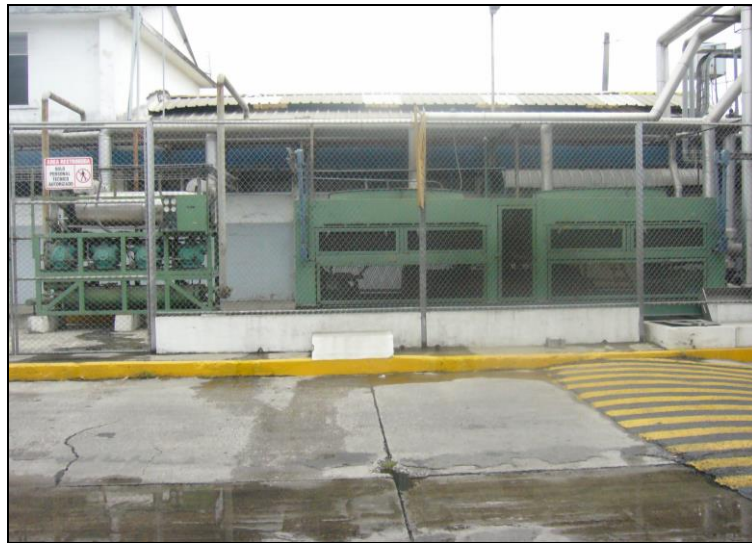
FIG. 2.15 UBICACIÓN DE CHILLERS
