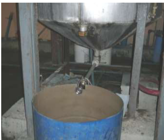
FIGURA 1.4. TUBERÍA DE DESCARGA DEL TANQUE DE MEZCLA
