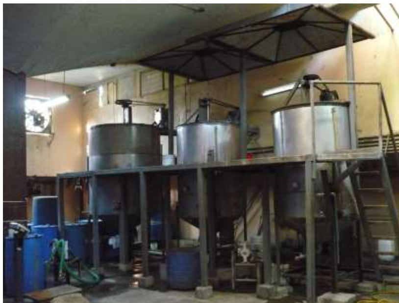
FIGURA 1.1. TANQUES DE MEZCLA
