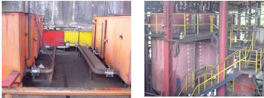
FIGURA 4.7 PRE-CLARIFICADORES Y CLARIFICADORES
