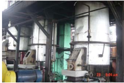
FIGURA 4.5 DIGESTOR DE 3 UNIDADES
