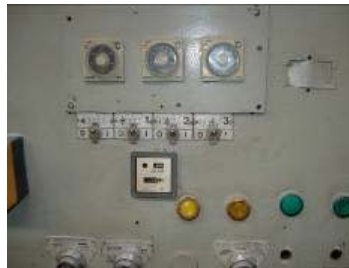
FIGURA 2.14 TABLERO INDICADOR DE TEMPERATURA
