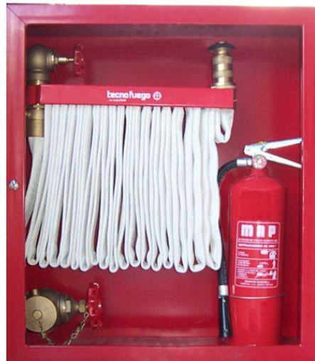
FIGURA 4.11.- CAJETÍN DE MANGUERAS CLASE III.
