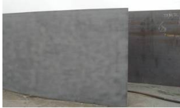
Figura 4.21 Superficies antes y después de sp10 (anillo)
