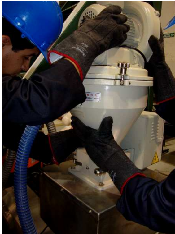
FIGURA 4.10 MONTAJE DE CARGADOR DE MATERIA PRIMA DE LA MÁQUINA EXTRUSORA.
