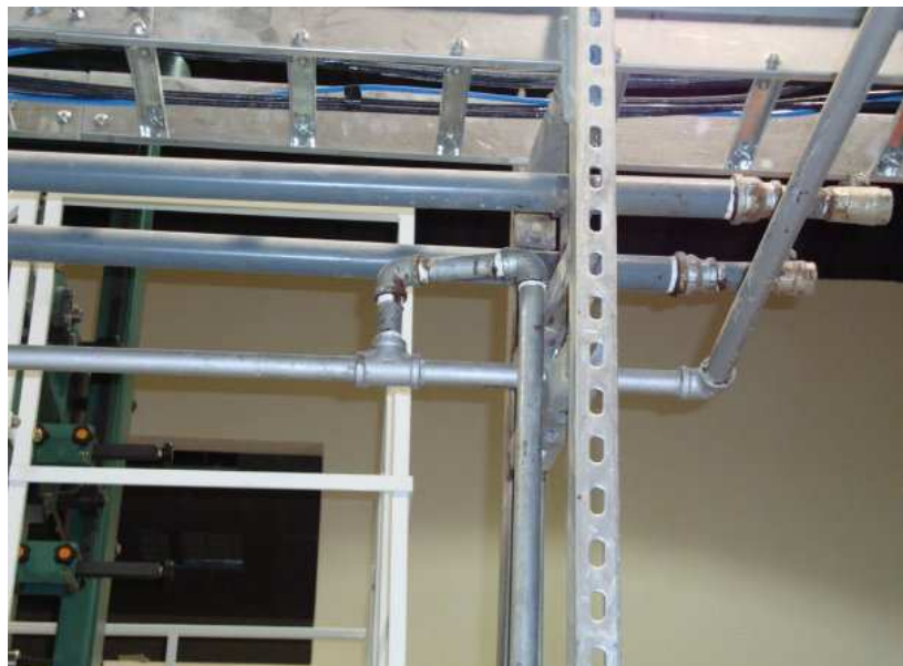
FIGURA 3.2 TUBERÍA DE SISTEMA DE ENFRIAMIENTO DE AGUA
