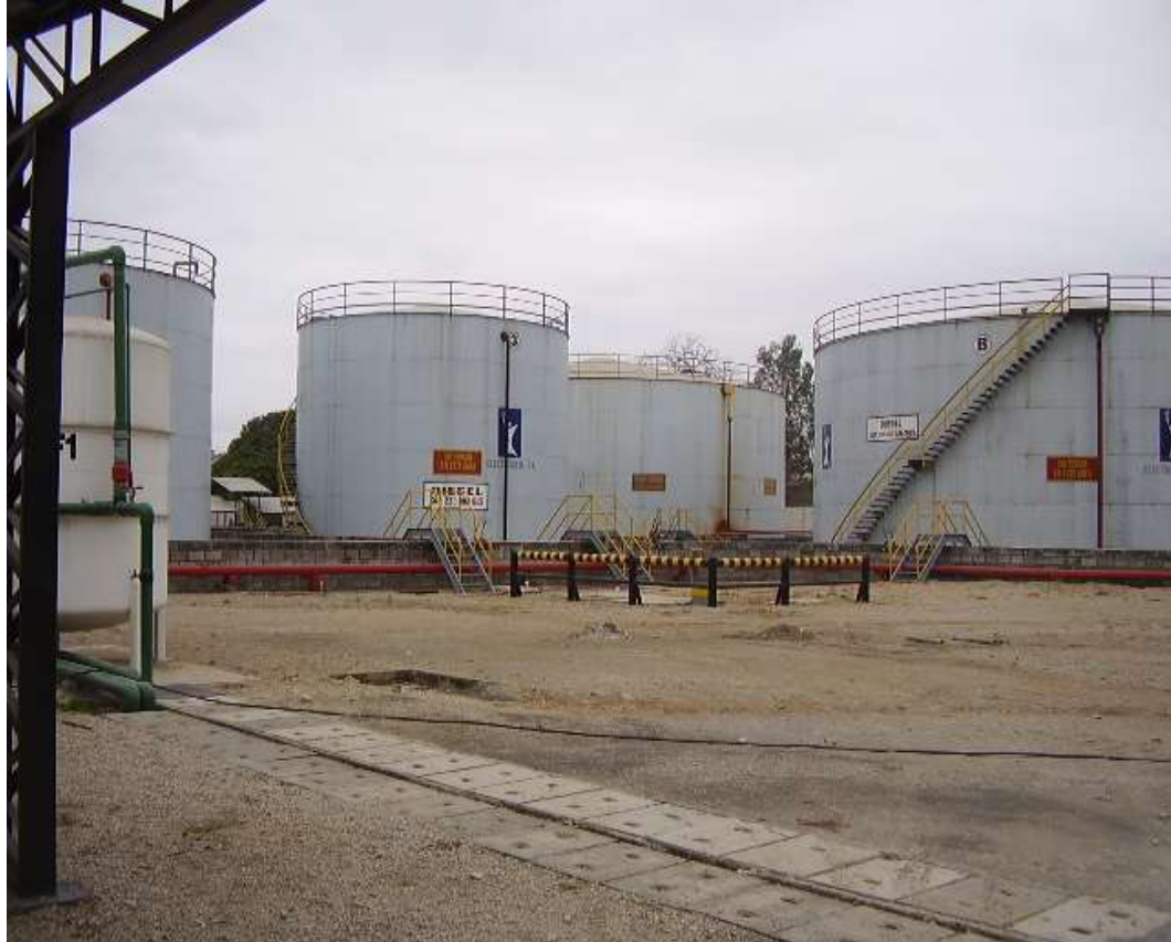
FIGURA G.3 TANQUES DE ALMACENAMIENTO DE COMBUSTIBLE
