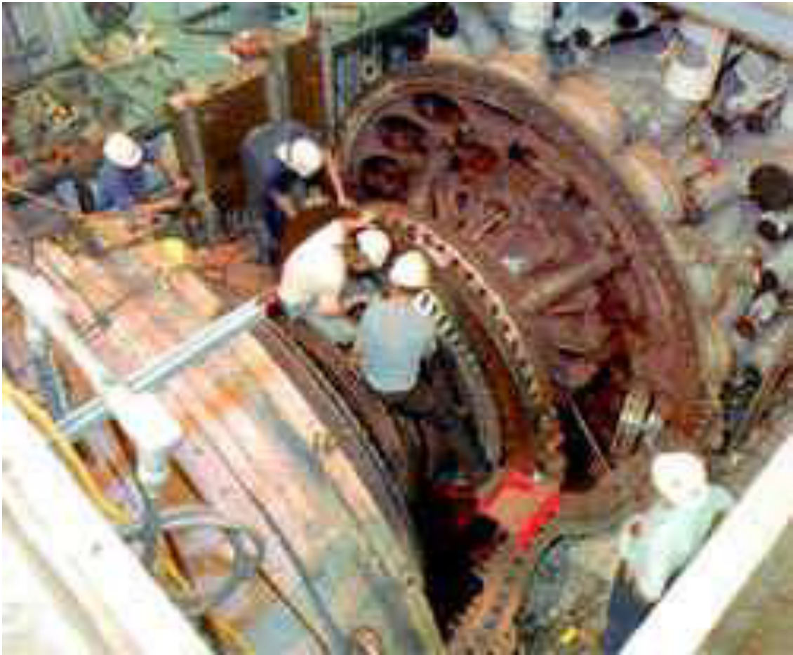
FIG.7.1. MANTENIMIENTO DE UNA TURBINA DE TIPO INDUSTRIAL
