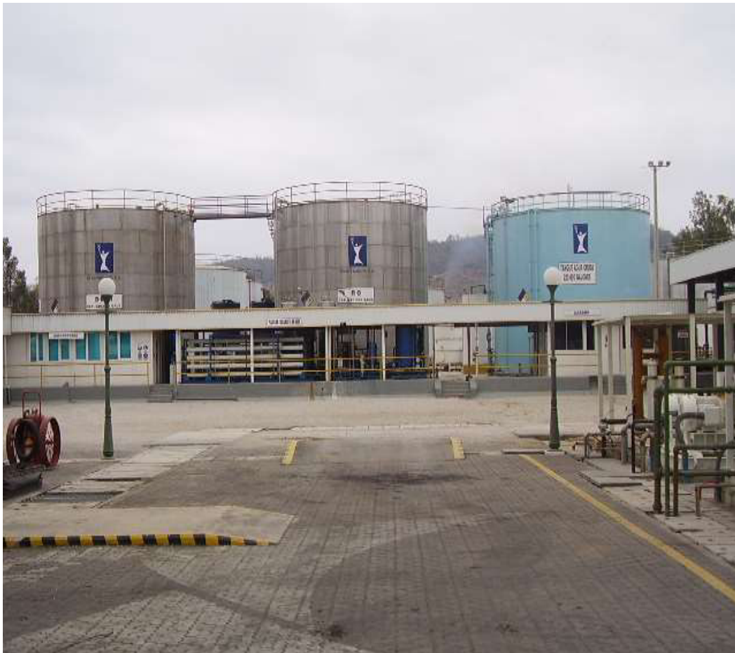
FIGURA G.1 TANQUES DE ALMACENAMIENTO DE AGUA
