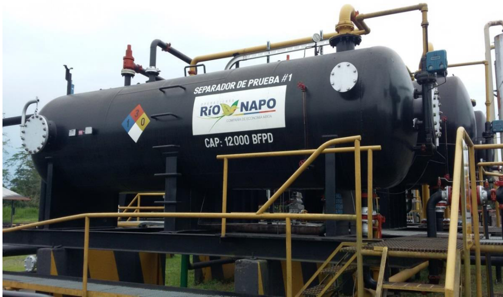
Figura 4.2 Separador de prueba Fuente:
