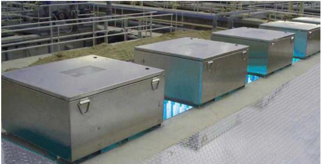
FIGURA 9. Sistema de desinfección ultravioleta.
