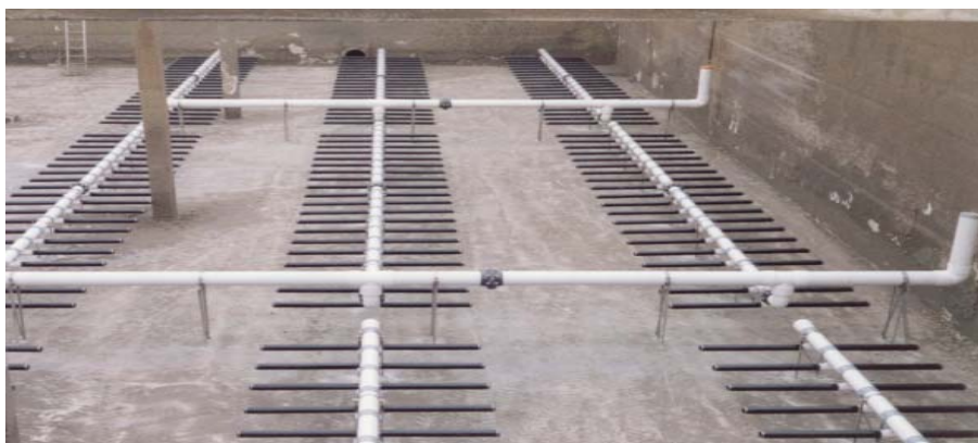
FIGURA 3.35. Diseño de un sistema de inyección de aire por medio de tuberías para el tratamiento de aguas residuales.
