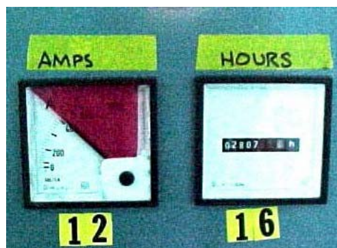
FIGURA 2.4. PUNTOS DE INSPECCIÓN PARA LECTURA DE AMPERAJE Y HORÓMETRO
