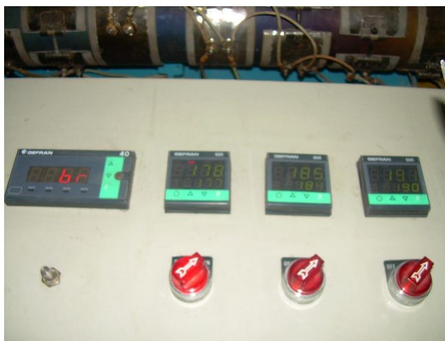
FIGURA 3.7 PANEL DE TEMPERATURAS DE LA EXTRUSORA FIMCP-ESPOL.
