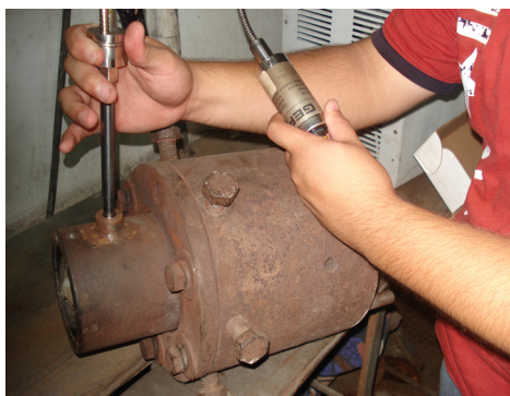
FIGURA 3.4 SENSOR DE PRESION DURANTE SU INSTALACION
