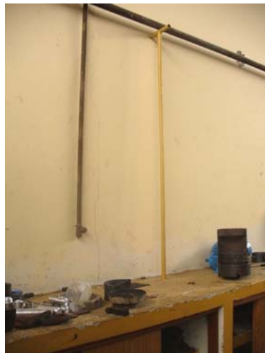
FIGURA 2.8 TUBERÍA MONTADA EN SOPORTES EN FORMA DE “TEES”
