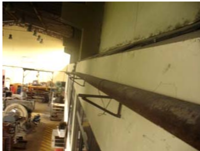
FIGURA 2.6 TUBERÍA MONTADA EN SOPORTES EN FORMA DE "A"
