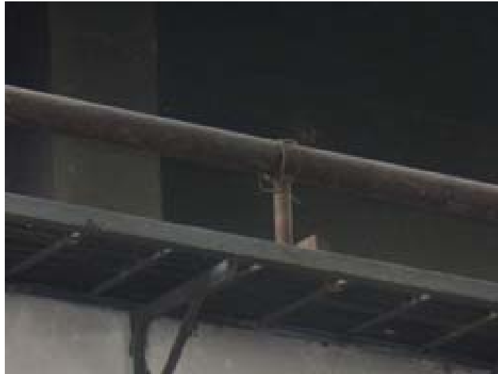
FIGURA 2.9 TUBERÍA MONTADA EN SOPORTES EN FORMA DE “MEDIA LUNA”
