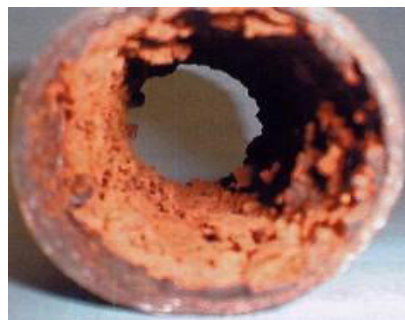
Figura 10 Tubería con incrustaciones
