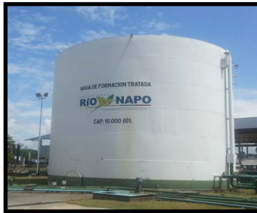
Fig. 9 Tanque de Agua Tratada
