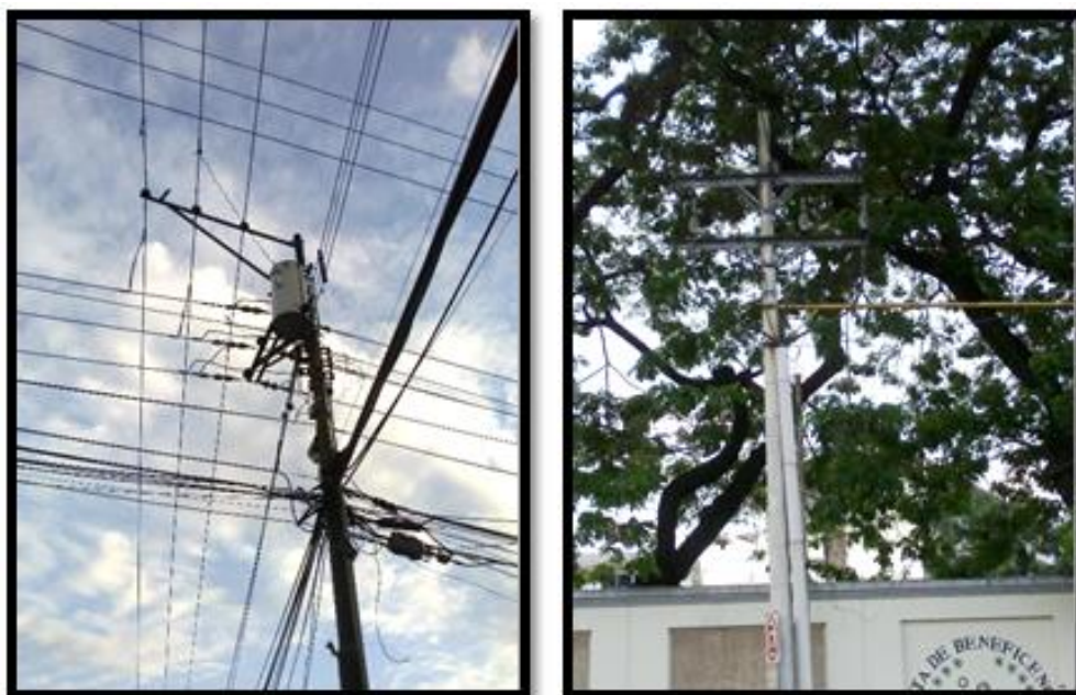
Figura 2.19: Estado actual de las redes de media tensión de la subestación Bien público.
