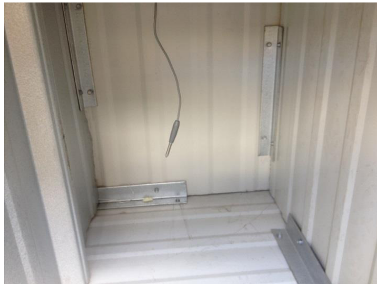
Fig. 4.16.- Termocupla tomando la temperatura del ambiente. (Autor: Alfredo Bozano, José Vera)
