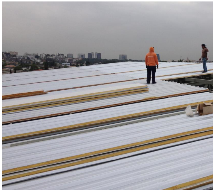
Fig. 6.5 Paneles distribuidos en cubierta. (Autor: Alfredo Bozano, José Vera)
