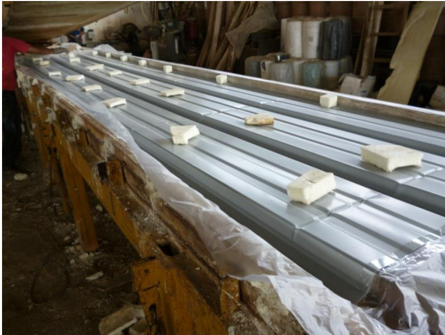
Fig. 3.5.- Poliuretano dispuesto en la lámina de superior para disponer la otra lamina inferior del panel sobre esta (Autor: Alfredo Bozano, José Vera)
