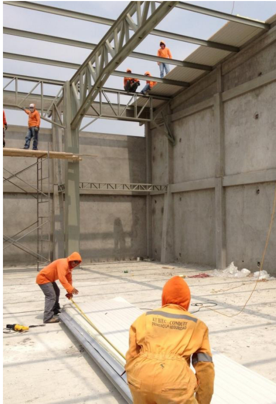
Fig. 6.4 Selección de paneles según su longitud para subida a estructura. (Autor: Alfredo Bozano, José Vera)
