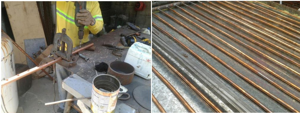
FIGURA 2.8. Izq. Perforaciones al tubo primario. Der. Banco de Tubos del Colector.
