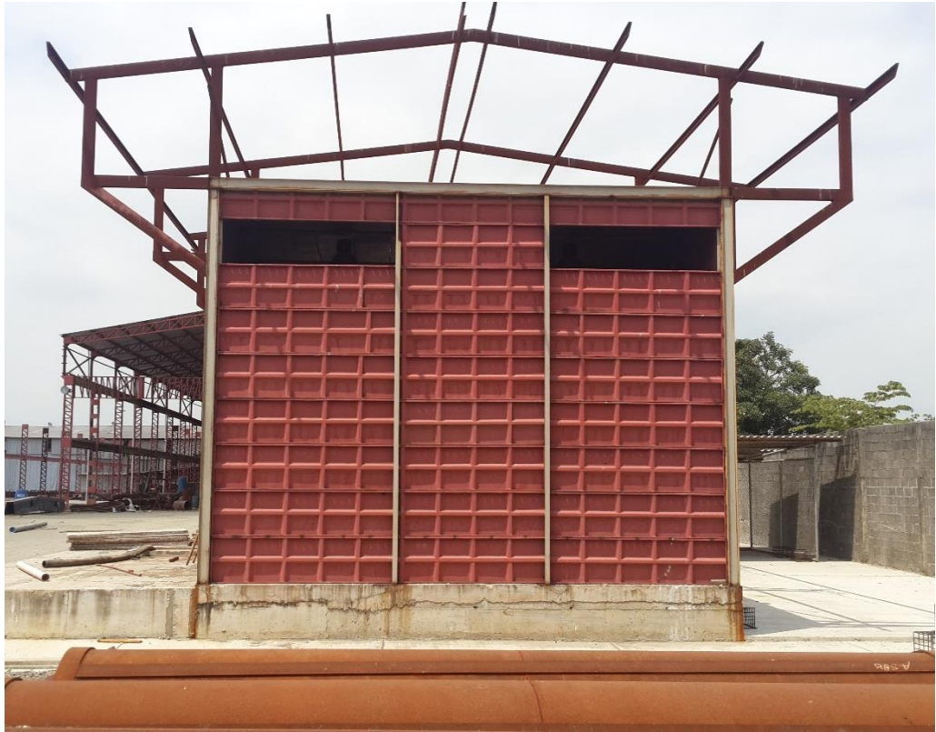
Estructura del cuarto de granallado – Vista posterior
