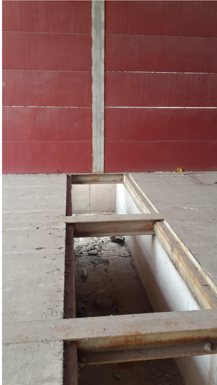
Cavidad intermedia para instalación de banda transportadora
