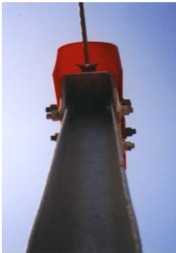
Figura 11.20 Estado actual de la extensión de poste
