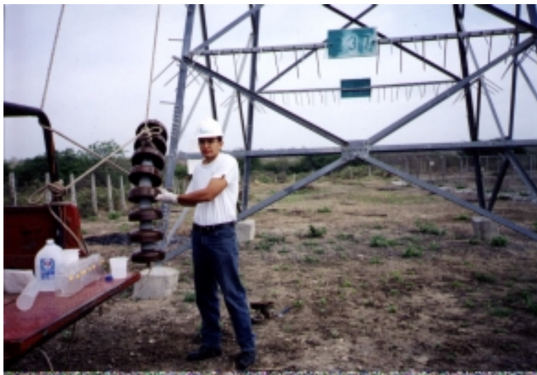
Figura 11.15 Recolección de muestras de la cadena de aisladores de suspensión ubicado en la Estructura # 237
