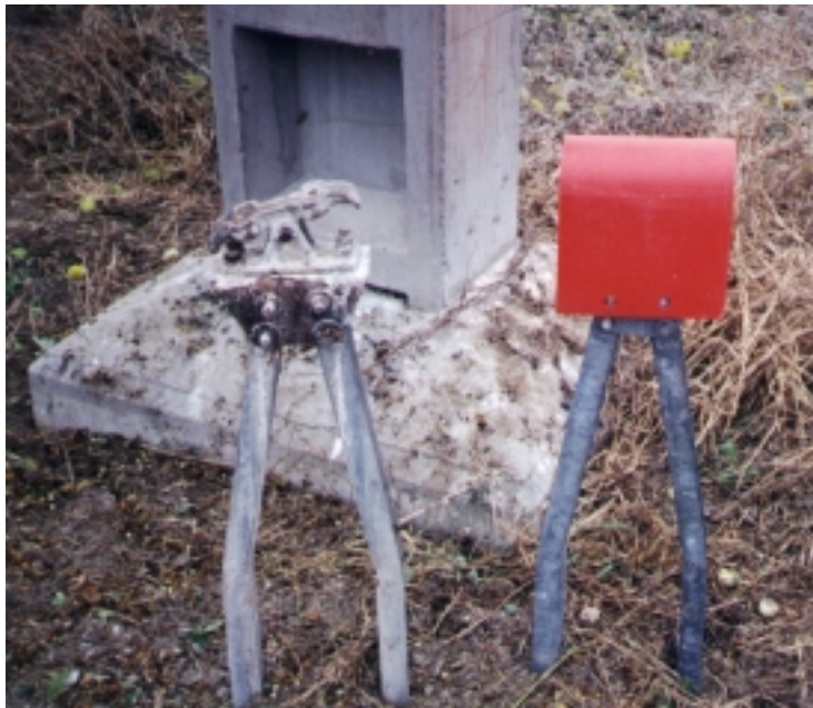
Figura 11.9 Extensión metálica para poste con su respectivo cobertor plástico.
