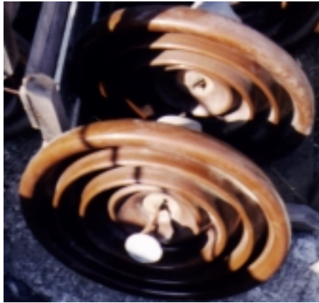
Figura 12.2 Cadena de Aisladores Retirados del tramo Pascuales – Las Juntas
