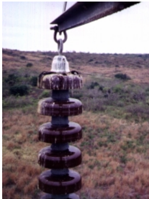
Figura 11.5 Cadena de Aisladores de La Estructura # 222 de la L/T Pascuales Sta. Elena a 138 KV.
