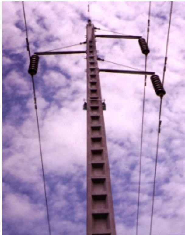
Figura 4.6 Poste de Hormigón Vibrado de la L/T Pascuales – Santa Elena
