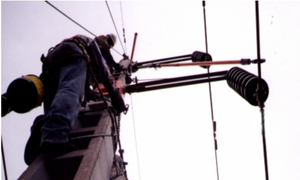
Figura 11.2 Pértiga de Enlace
