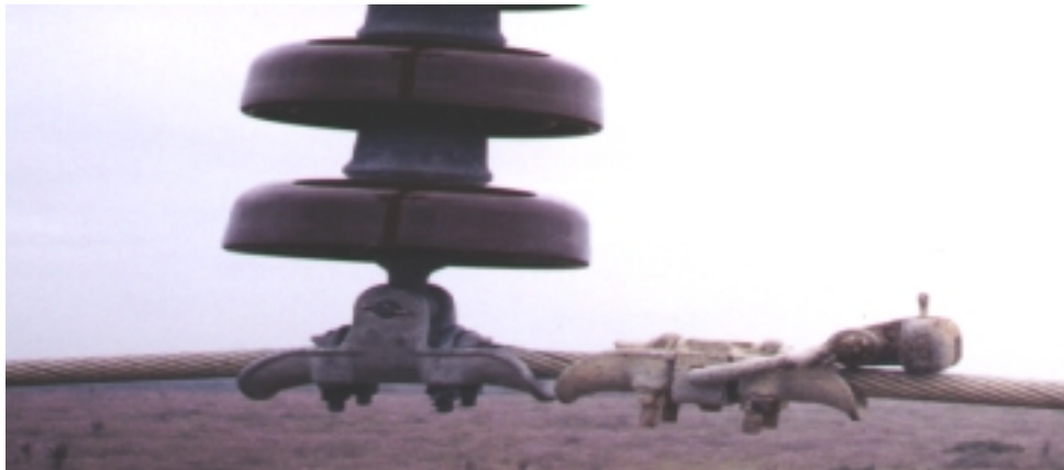
Figura 11.16 Diferencia entre una grapa de suspensión nueva y una corroída
