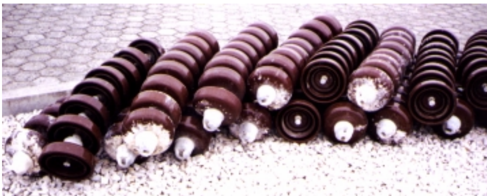
Figura 5.17 Cadenas Aisladores de Suspensión Retiradas de la L/T Pascuales - Santa Elena a 138 Kv.
