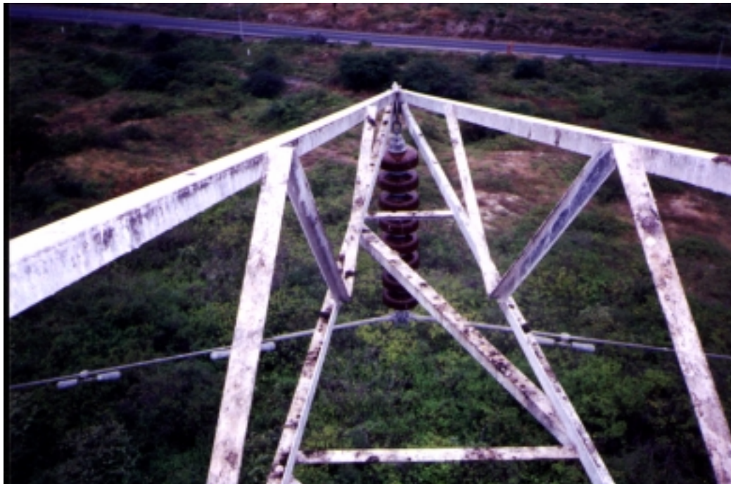
Figura 4.2 Corrosión en la Cruceta de la Estructura Metálica Tipo Suspensión Pesada de la Línea Pascuales - Santa Elena a 138KV.
