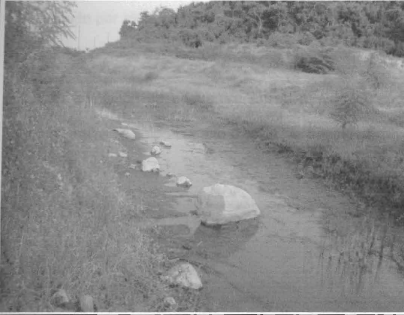
Figura 1.2.- Flujo efimero en el cauce que descarga a la alcantarilla 1+420
