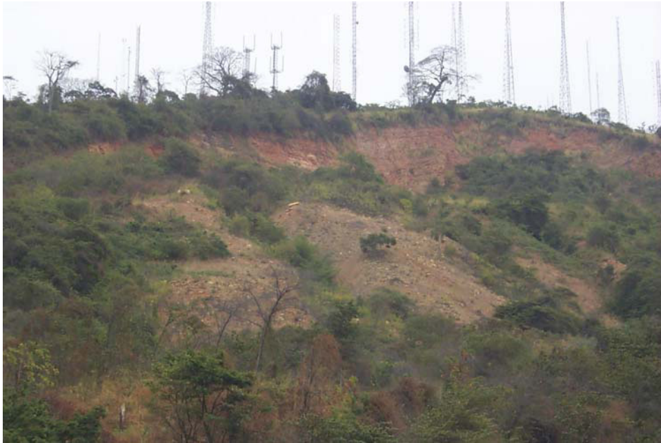
Foto 2.4. Cerro Azul. Deslizamiento de material coluvial: lutitas y limonitas de la formación Guayaquil, fuertemente meteorizadas.
