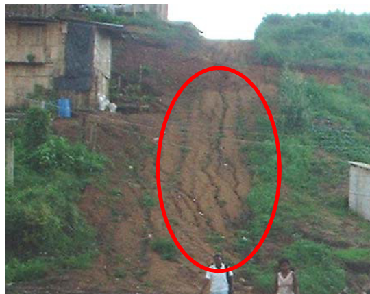
Foto 1.1 Sector Balerio Estacio – 614160/9766242, PSAD 56, presencia de cárcavas en el acceso peatonal.
