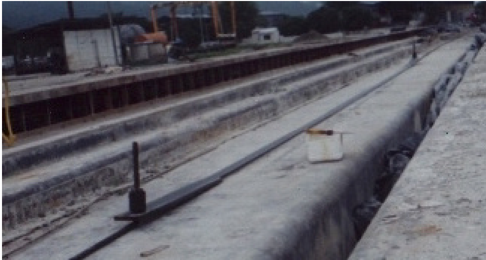
Foto 4.11. Sistema en Banco de Tensado
