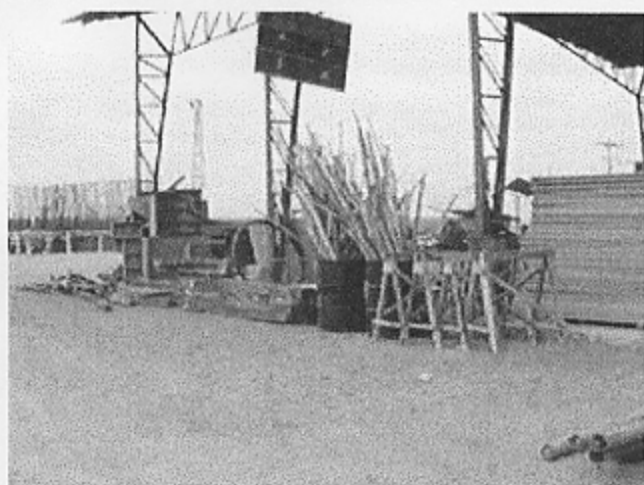
▪ Foto 9. - Central de Encofrados. Campamento Atahualpa.
