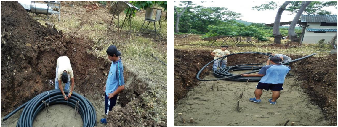
Figura 17. Desacople de la tubería.
