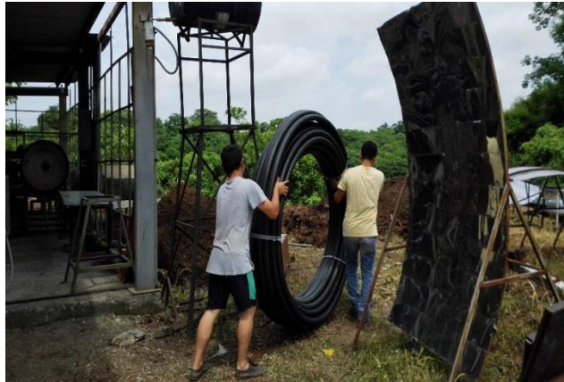
Figura 14. Tuberías de polietileno.
