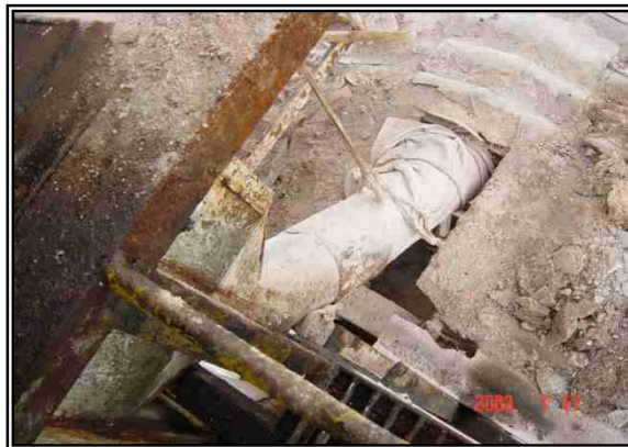
DUCTO PRINCIPAL. VISTA SUPERIOR
