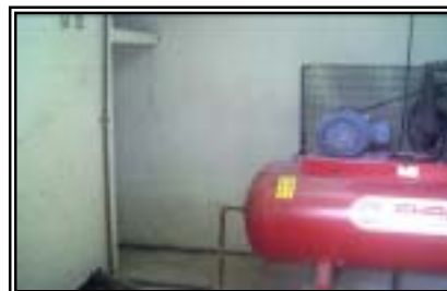
FIGURA 3.11. COMPRESOR DE LA MEZCLADORA
