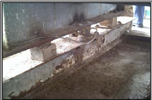
BASE DEL MEZCLADOR. FALTA DE ANCLAJE
