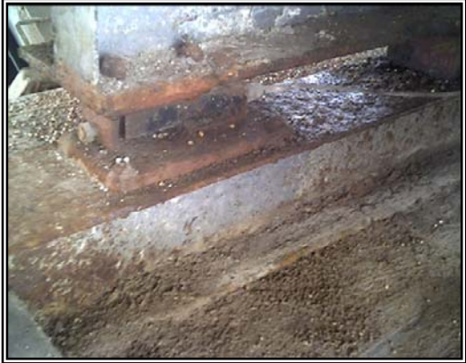
CELDA DE CARGA 1 DE 4
