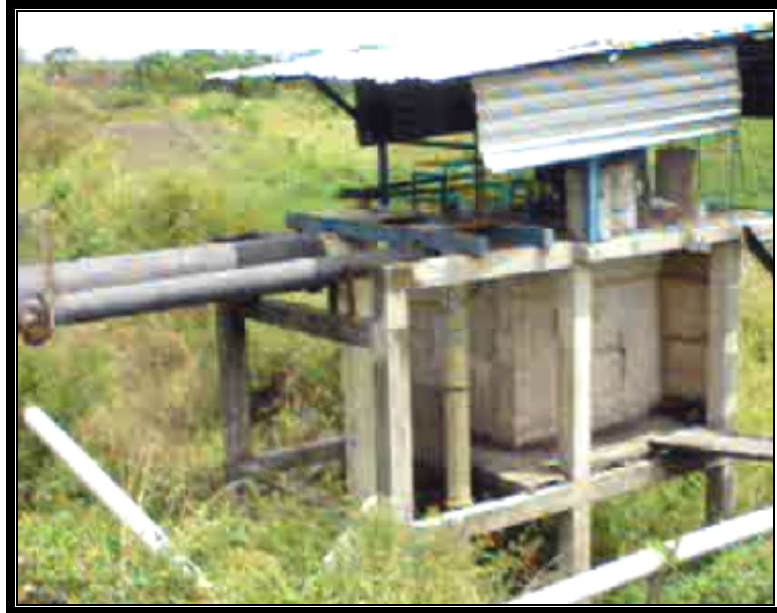
Figura 25. Bomba de Eliminación de Aguas Residuales
