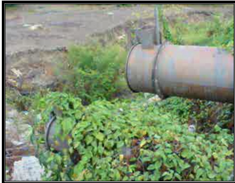
Figura 26. Tubería de Eliminación de Aguas Residuales
