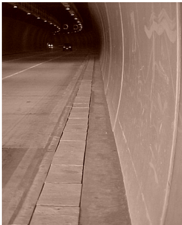
Figura 4. 5 Tapas de drenaje
