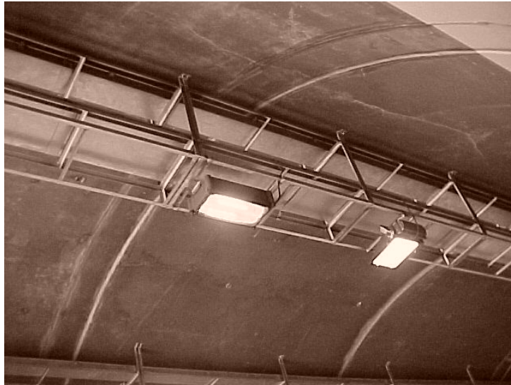
Figura 4. 10 Luminarias y canaletas en Túnel
