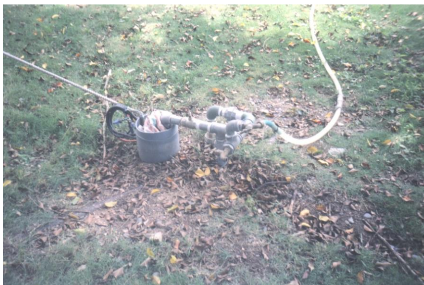
Figura 1.6 Pozo de agua subterránea
