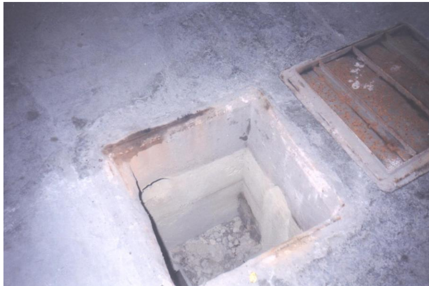
Figura 1.8 Pozo de conexión de tubería de retorno subterránea
