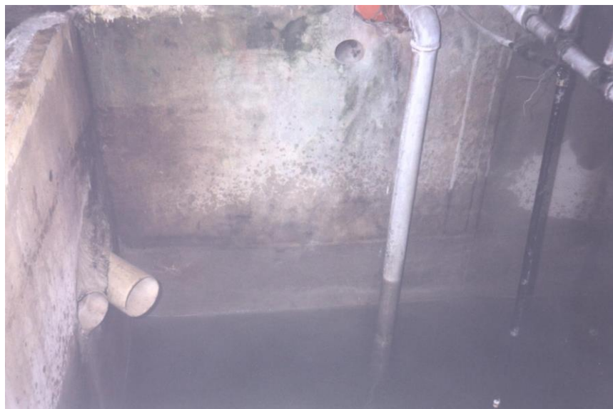
Figura 1.9 Interior de la cisterna de enfriamiento
