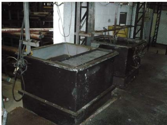
FIGURA 2.23 TANQUES DE AGUA Y ACEITE
