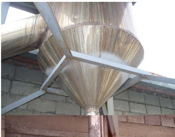
FIGURA 3.7 TORRE DE LAVADO DE GASES
