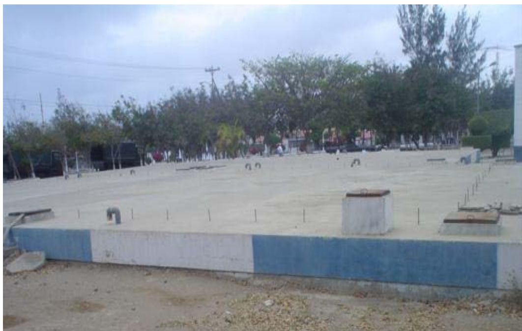
FIGURA 1.7 CISTERNA DE ALMACENAMIENTO
