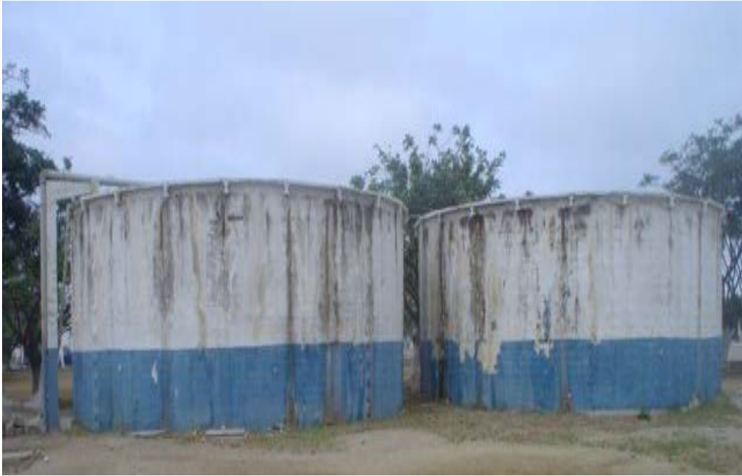
FIGURA 1.6 TANQUES CILÍNDRICOS DE ALMACENAMIENTO
