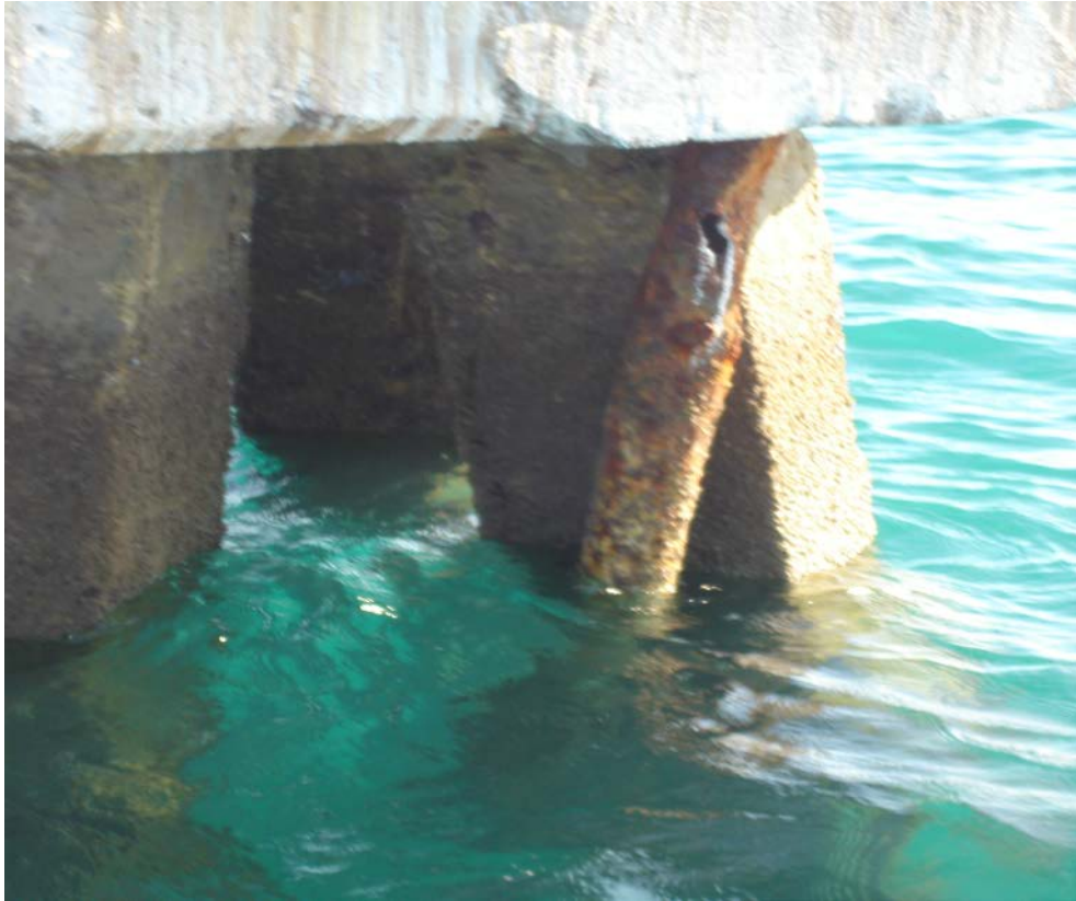
FIGURA 4.5 ESTADO ACTUAL DE LAS TUBERÍAS
