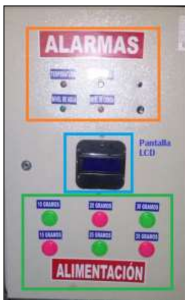
Figura 3.6: Caja de Controles- acceso local
