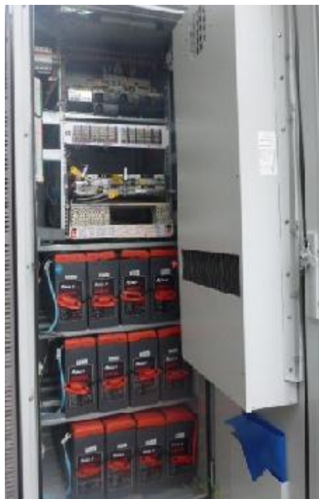
Figura 2.32: Gabinete Power Eltek, Planta de Poder y Equipos Indoor de MW.
