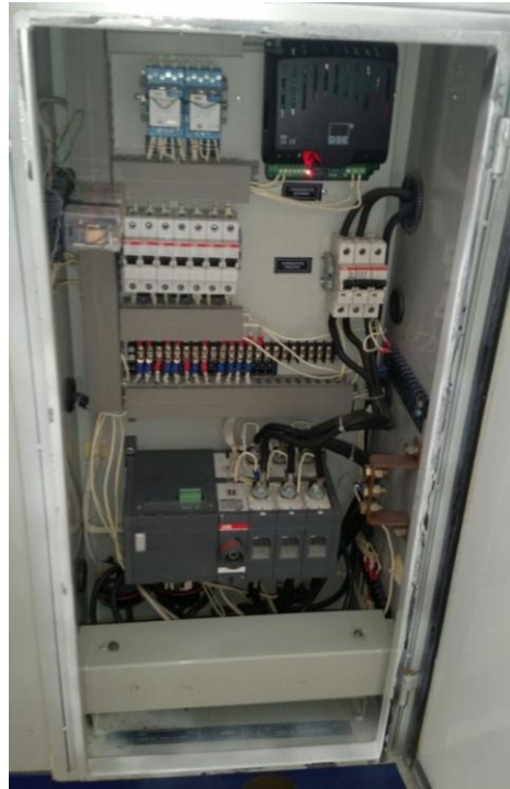
Figura 2.30: Instalación real de Tablero de transferencia en RBS Fuente: Los Autores.
