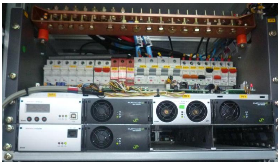
Figura 2.28: Instalación real de Rectificadores basado en Eltek Fuente: Los Autores.
