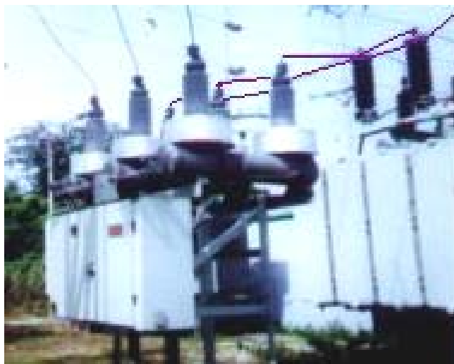
Figura 3.43: Barras que van del interruptor SF 6 a los pararrayos del lado de 69 Kv del transformador
