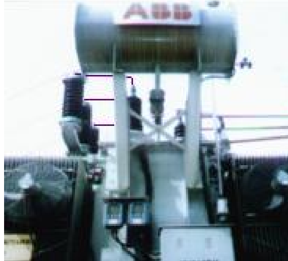
Figura 3.45: Barras que van de los pararrayos a los pasatapas del lado de 69 Kv del transformador.
