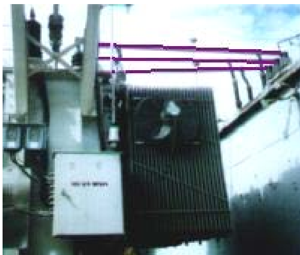
Figura 3.47: Barras que van de los pasatapas del lado de 13.8 Kv. del transformador a los aisladores tipo poste ubicados sobre la Metalclad.
