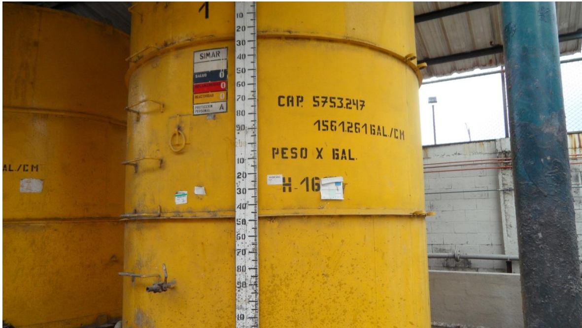
Figura 1.1. Tanques de almacenamiento temporal del látex en PINTEC.
